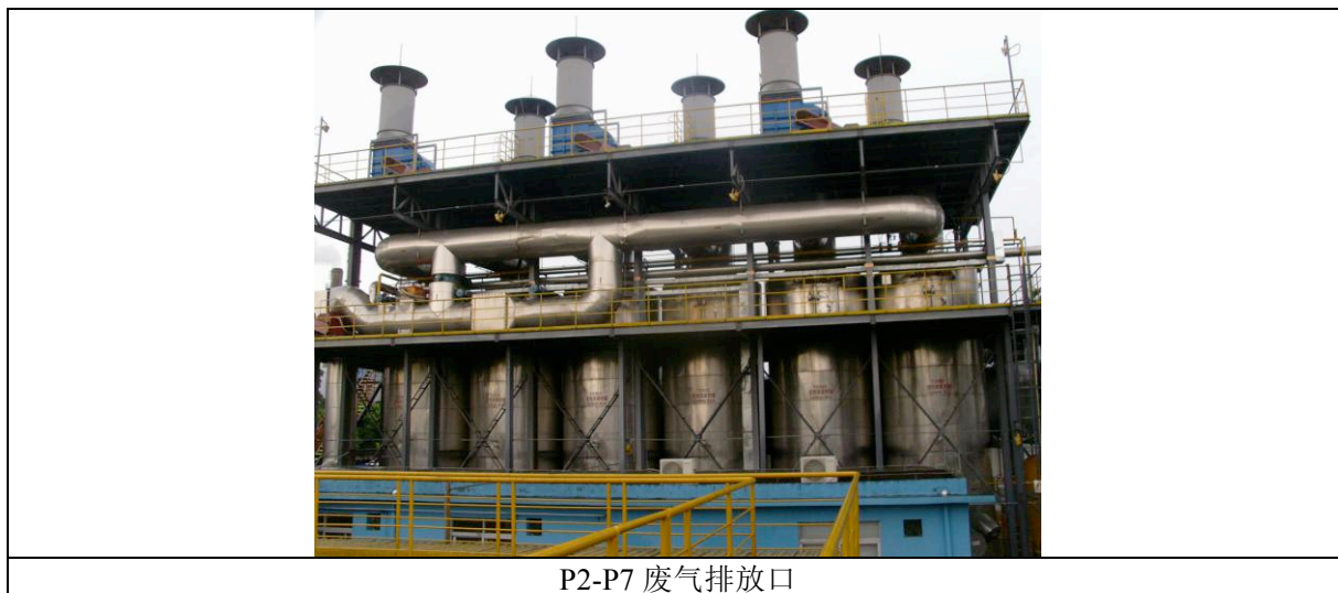
图 4.2-2 废气排放口照片
